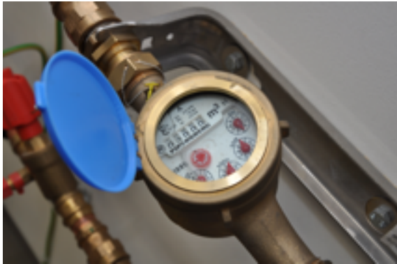
Der Übergabepunkt - die Wasseruhr trennt die Verantwortungsbereiche.
